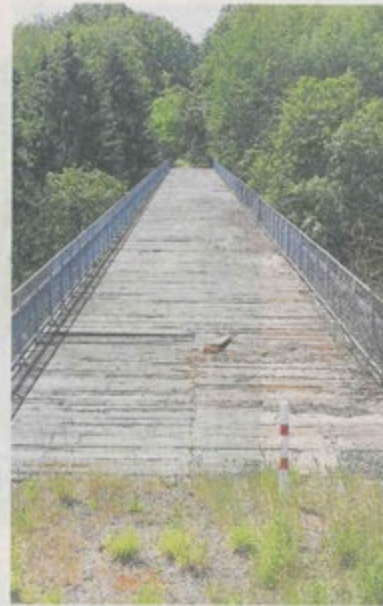
Bereits seit Juni 2014 dürfen keine Fußgänger und Radfahrer mehr über die Eisernerne Brücke bei Freisen gehen oder fahren. Wegen erheblicher Baumängel wurde sie gesperrt.
