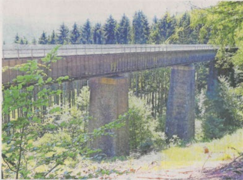
Die in den 1930er-Jahren erbaute Eisernerne Brücke soll im Zuge des Freizeitweg-Baus saniert werden.
