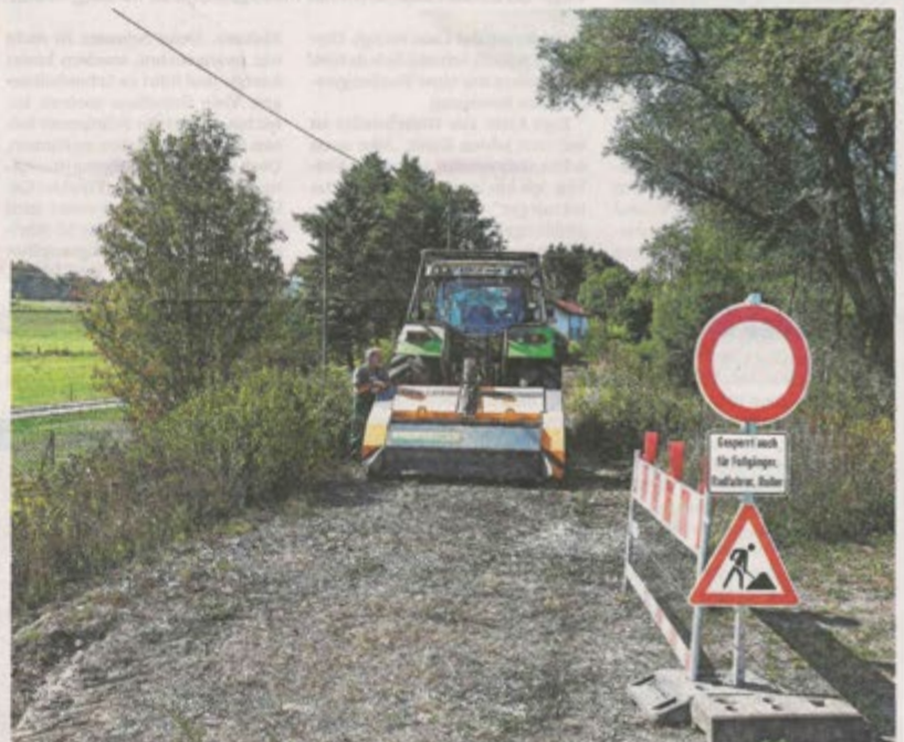
An dem neuen Freizeitweg wird bereits gearbeitet. Am Montag war auch der offizielle Spatenstich. FOTO: B&K
