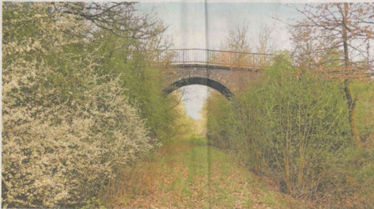
Fünf Brückenbauwerke sind auf dem Teilstück in der Gemeinde Freisen. Alle sind in Ordnung, sagt Bernd Zollhöfer vom Velo-Büro Saar.
