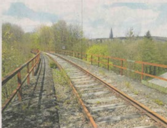
Insgesamt drei Brücken werden Nutzer des Freizeitweges in der Gemeinde Nonnweiler überqueren.
